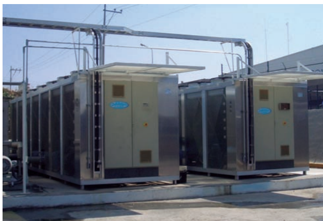
En esta página y en la siguiente, algunas de las instalaciones realizadas a clientes de Equifab.
